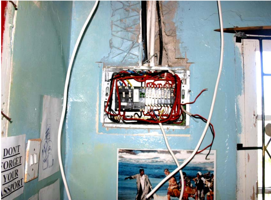
Port St. Johns, Süd Afrika: Bei diesem Sicherungskasten wurde kein Information Hiding angewendet
